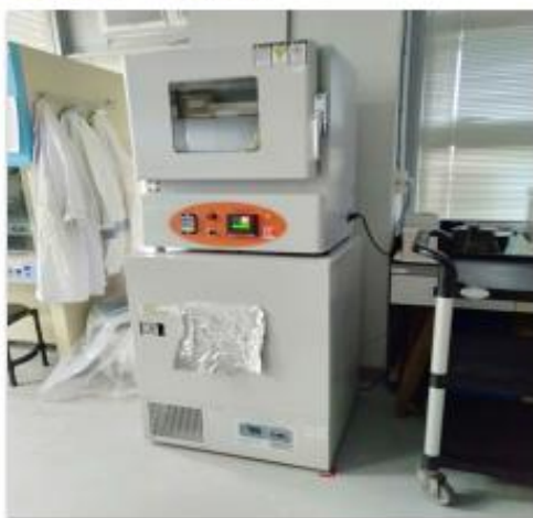
兩台發熱性電器設備堆疊一起，且附近堆放雜物，易引起火災等風險。
