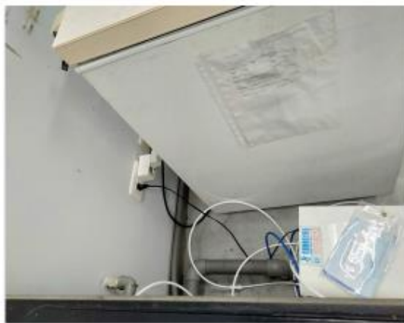
電線擺放有危害人員之絆倒之虞慮，且未落實未使用之電器設備「人離電切」。
